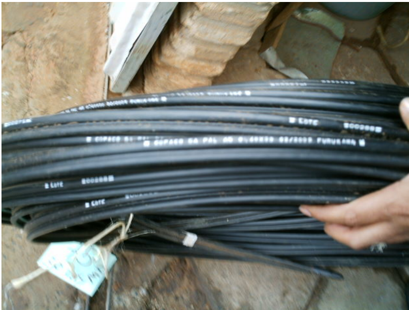
Foto N° 4: Cable de Bajada 0,8mm. Averiado.
