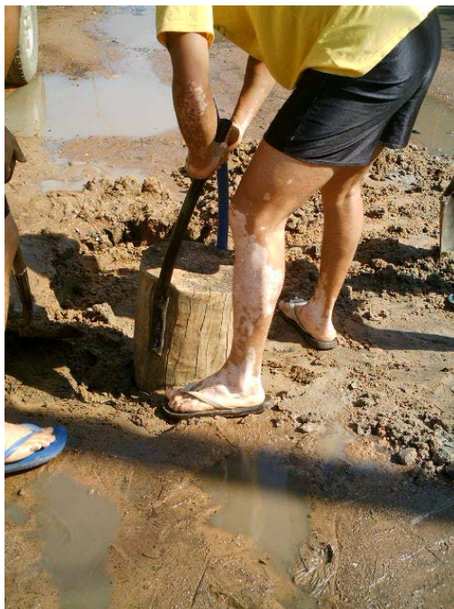
Foto N° 12: Compactación si ningún control de densidad. Orden de Servicio N° 589859
