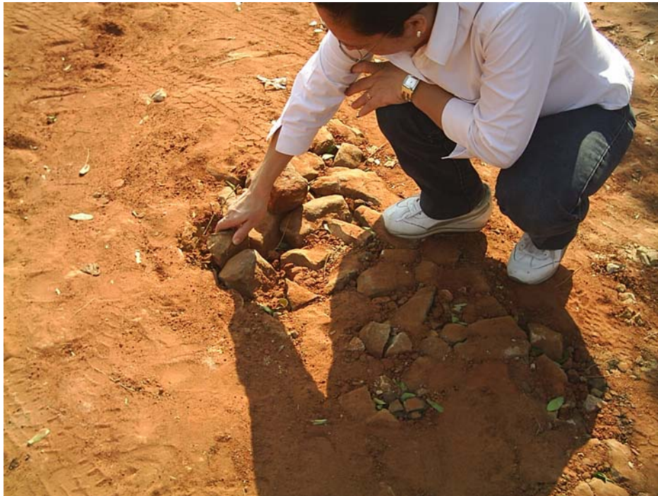
Foto N° 17: Resultado del mal proceso de compactación. Orden de Servicio N° 76146
