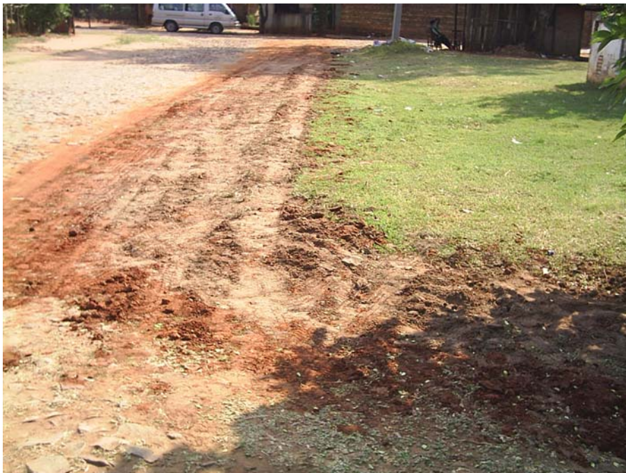
Foto N° 15: No utilización de ripio en el empedrado. Orden de Servicio N° 76034
