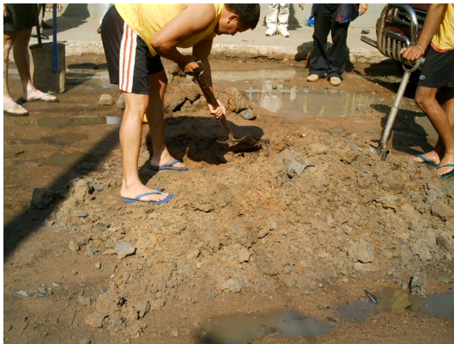
Foto N° 8: Relleno con material inadecuado. Orden de Servicio N° 581063
