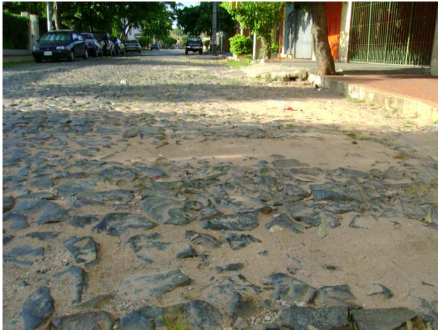
Foto N° 1: Sucesivas reparaciones. Pavimento hundido por compactación inadecuada.
