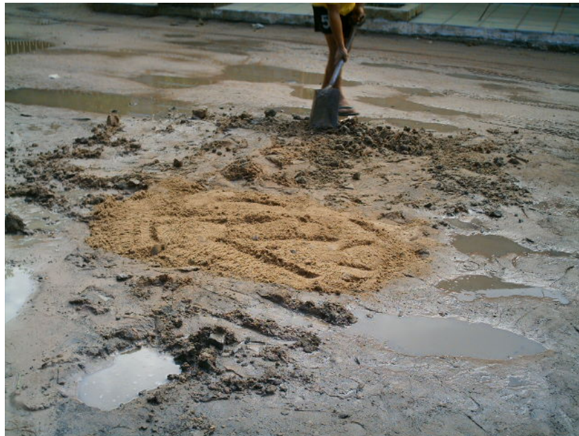
Foto N° 6: Reparación sin señalización adecuada. Orden de Servicio N° 581063
