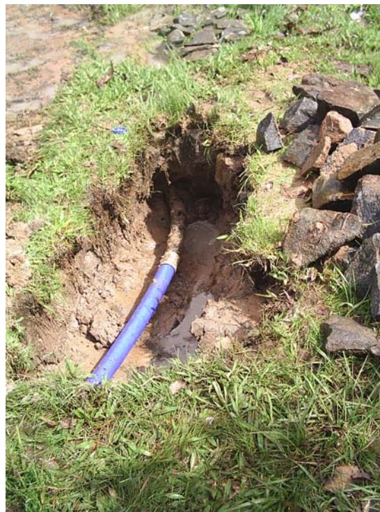
Foto N° 10: Cañería reparada sin asiento de arena. Orden de Servicio N° 589859
