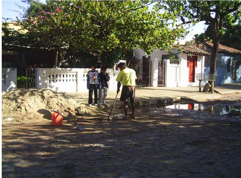
Foto N° 5: Reparación sin señalización adecuada. Orden de Servicio N° 581063
