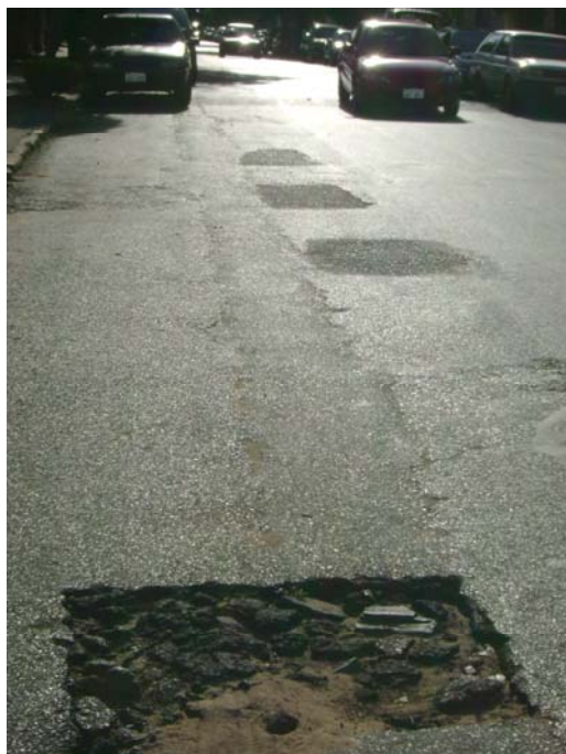
Foto N° 2: Sucesivas reparaciones. Cambio de tubería. Nueva reparación.
