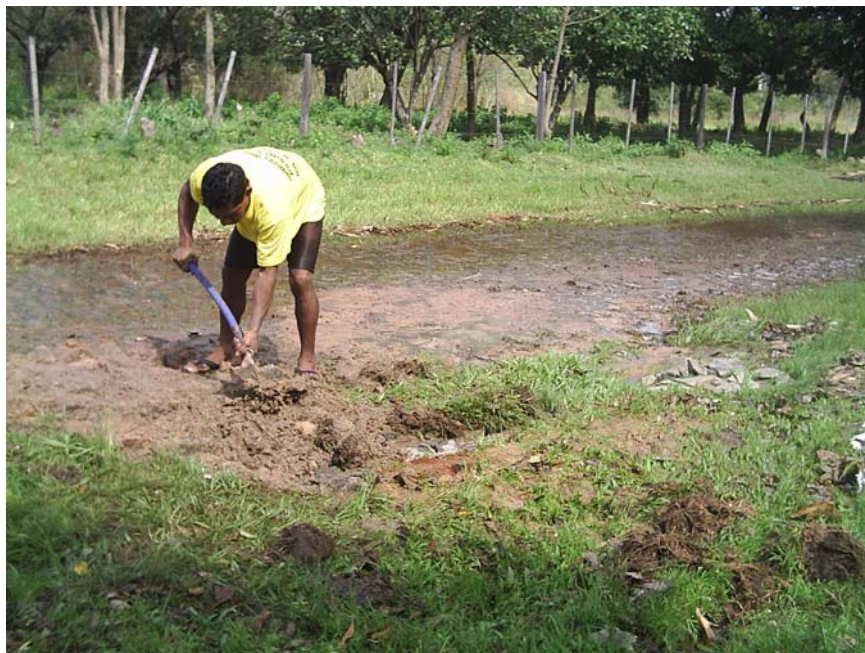
Foto N° 16: Suelo saturado utilizado en vez de ripio. Orden de Servicio N° 589859
