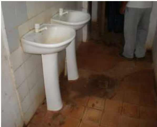
Foto N° 7 SS.HH. Guardias Colocación de materiales que no cumplen con las especificaciones técnicas
