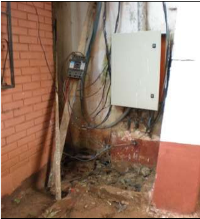
Foto N° 15 Tablero Principal. Colocación, ubicación e instalación precaria.
