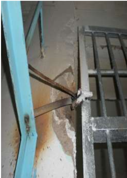
Foto N° 1 Reja (celdas) sin terminación. Anclaje y soldadura deficiente.
