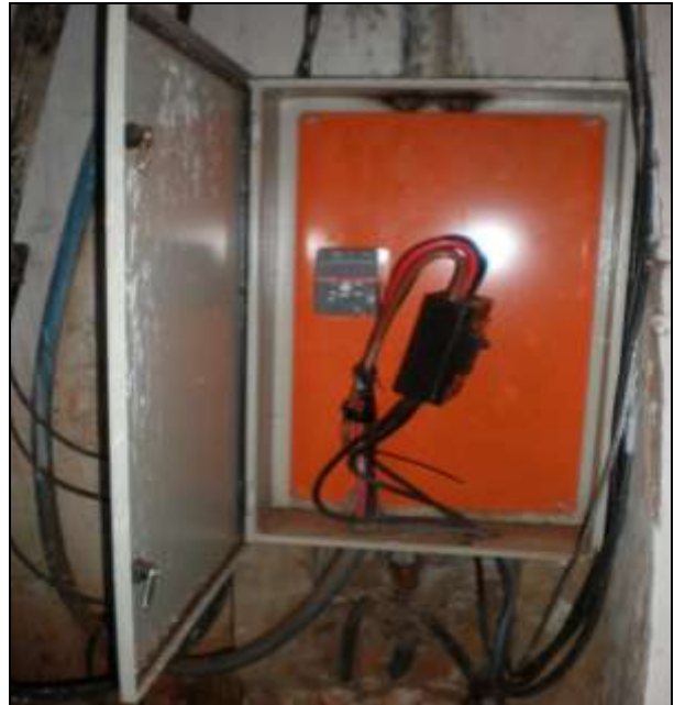
Foto N° 13 Tablero sin protección ni identificación
