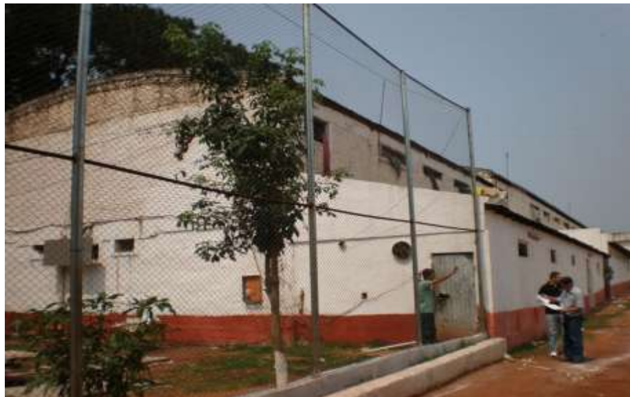
Foto N° 11 No cumple con las especificaciones técnicas. No cuenta con "Obstáculos de protección perimétrica" de acero inoxidable con cuchillas tipo arpón, como tampoco con el coronamiento con alambre helicoidal.
