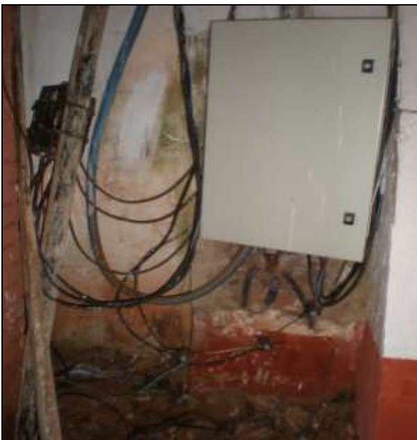
Foto N° 12 Tablero Principal en acceso a Penitenciaría
