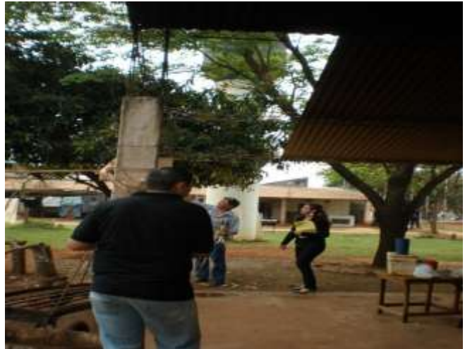
Foto N° 6 Techo chapa de Zinc del Rancho sin terminar.
