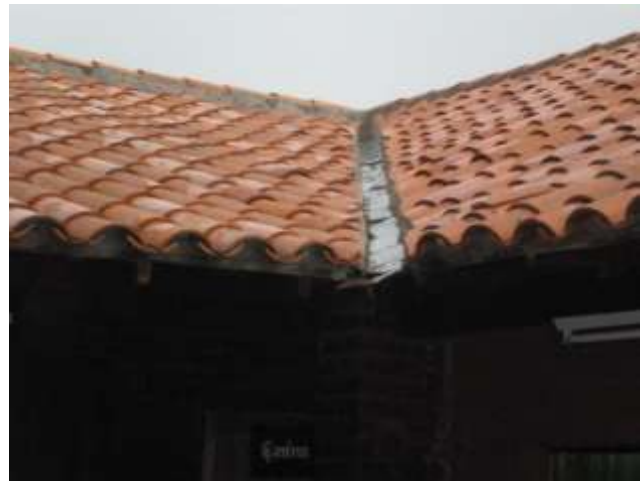
Foto N° 8 Falta canaleta de bajada y aérea. Mala colocación de canaleta limahoya
