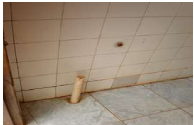
Foto N° 4 SS.HH. Sexado. Faltan colocación de artefactos sanitarios.
