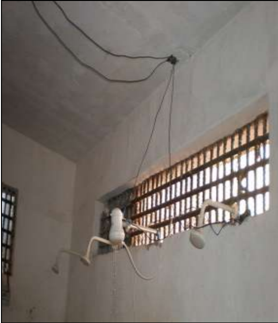
Foto N° 18 Instalación eléctrica en contravención al Reglamento de baja tensión de la ANDE
