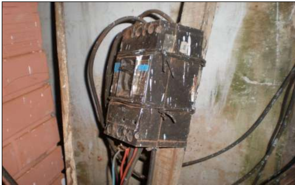
Foto N° 17 Colocación indebida de Llave Temo magnética
