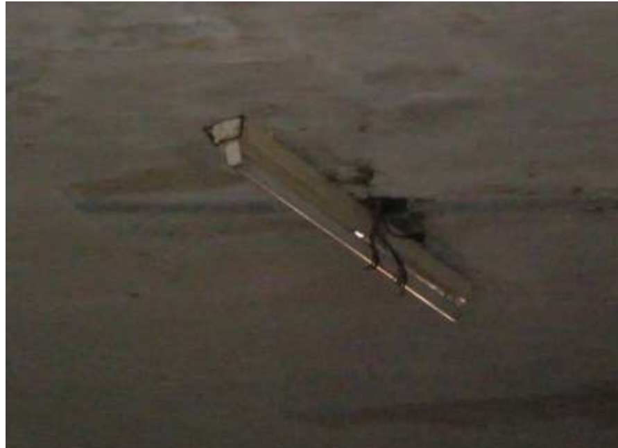
Foto N° 28 Equipos de fluorescentes sin capacitores
