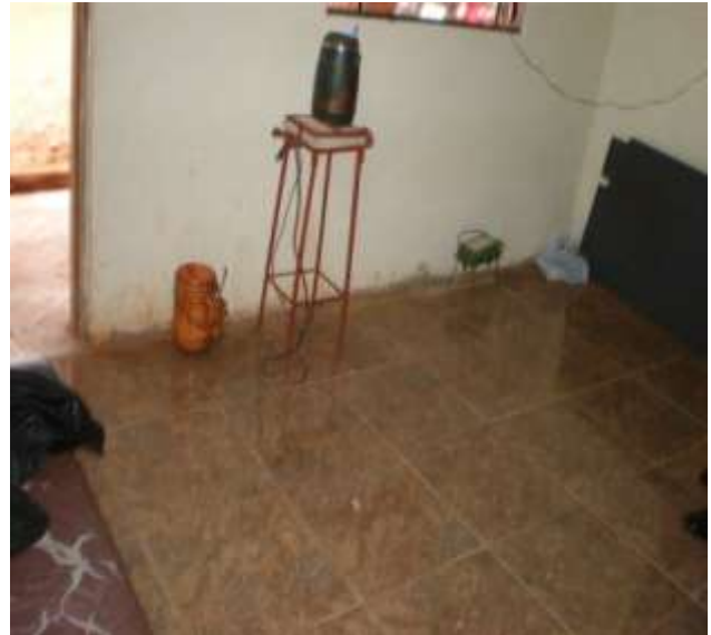
Foto N° 10 Falta colocación de zócalo
