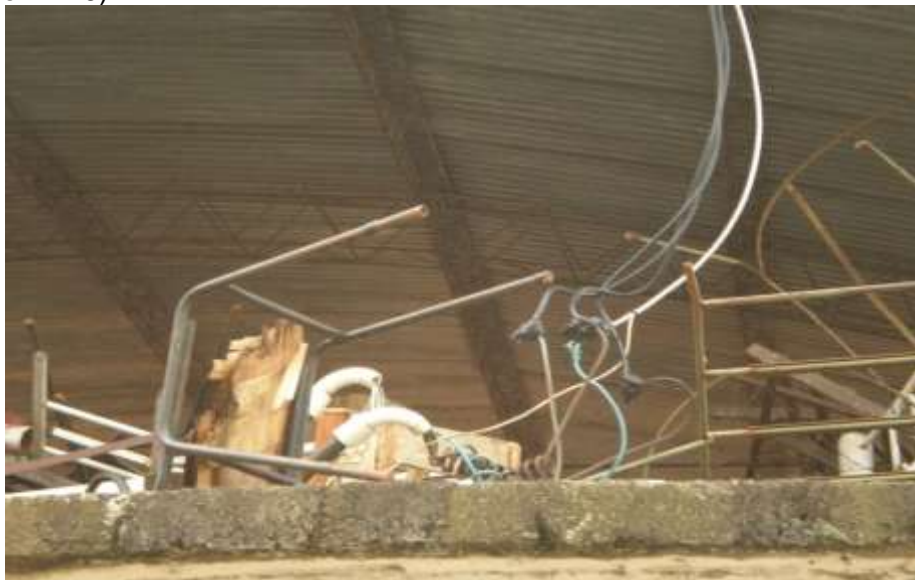
Foto N° 29 Conductores de alimentación empalmados irregularmente (Pabellón de Mujeres)
