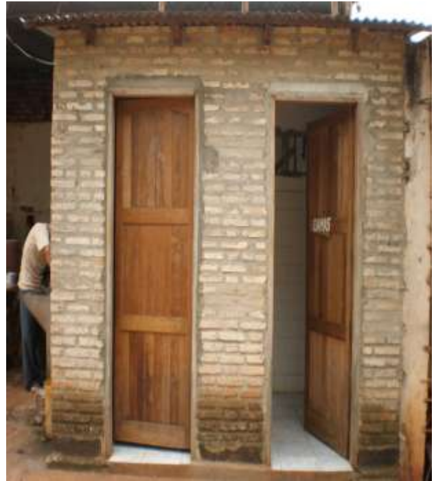
Foto N° 2 SS.HH. Sexado con estructura de madera. Faltan contramarcos
