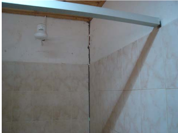
Rajaduras en la unión de las paredes
