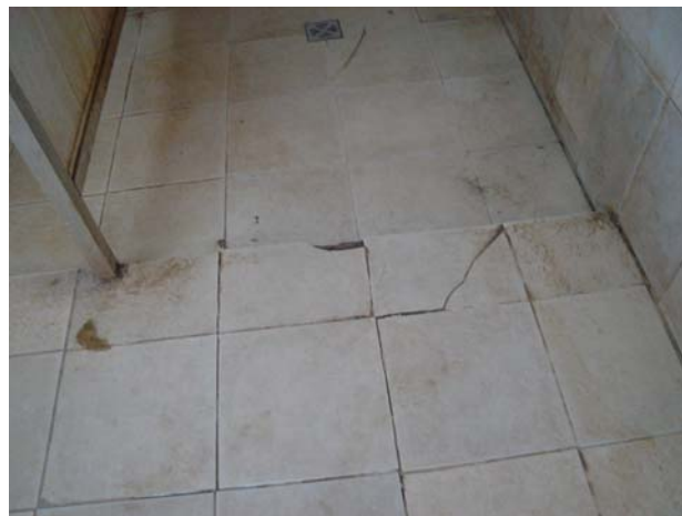
Piso roto y hundido
