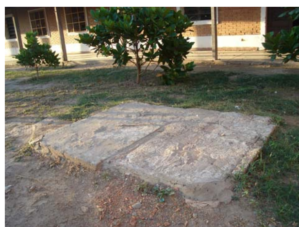
Mala terminación de la cámara séptica
