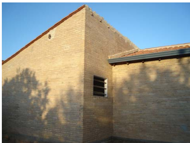
Mala terminación de la cumbrera
