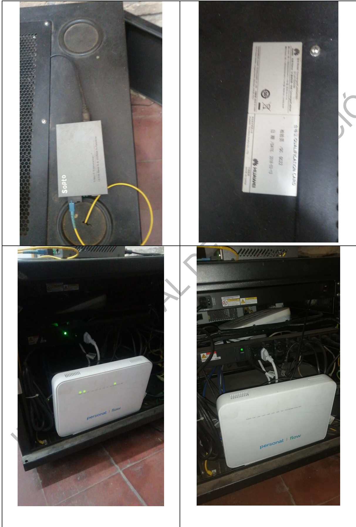
Fuente: Equipos de WIFI - Fotografías captadas durante verificación in situ.
