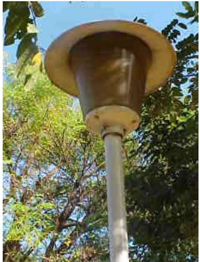
FOTO N° 10: Plaza Alicia Lynch. Artefacto de iluminación antiguo existente (reacondicionado).
