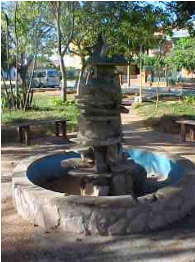
FOTO N° 12: Plaza Alicia Lynch. Vista de la fuente de agua (al momento de la verificación se encontraba fuera de uso). Se observa desprendimiento del revestimiento de piedra del borde.
