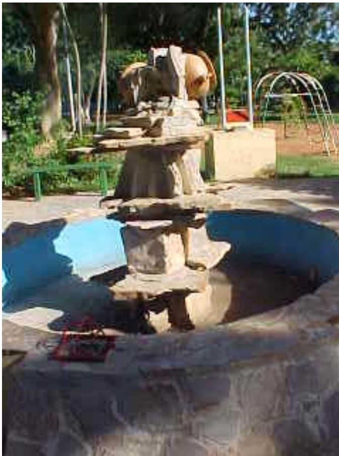
FOTO N° 15: Plaza Las Residentas. Vista de la fuente de agua, al momento de la verificación se encontraba fuera de uso. Se observa desprendimiento de uno de los cántaros superiores.
