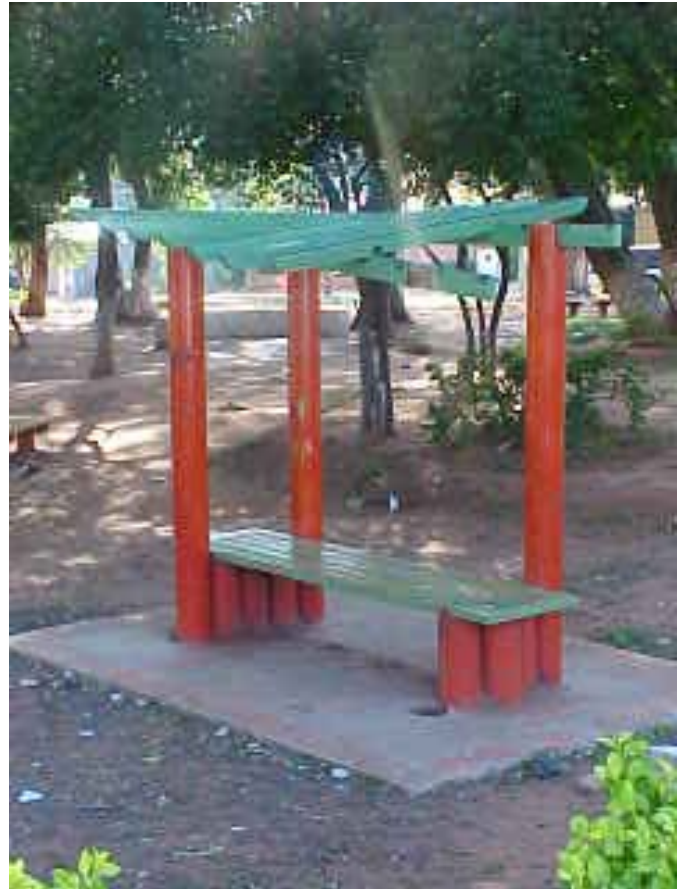
FOTO N° 14: Plaza Las Residentas. Bancos con pergolados deteriorados.
