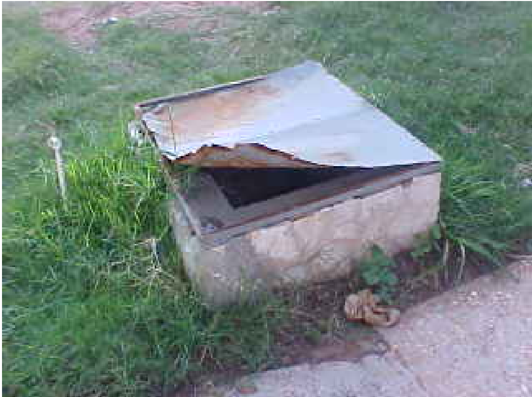
FOTO N° 16: Plaza Las Residentas. La tapa del registro que aloja la bomba de agua de la fuente fue violentada.
