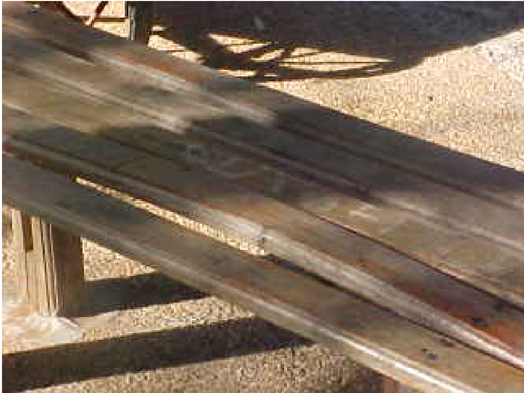
FOTO N° 5: Plaza Alicia Lynch. Bancos nuevos colocados. Nótese que las maderas se encuentran arqueadas.
