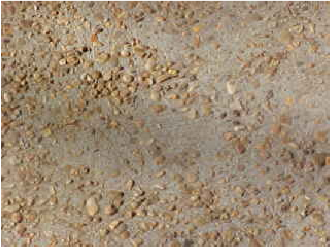
FOTO Nº 7: Plaza Alicia Lynch. Mala terminación del piso de canto rodado in situ.
