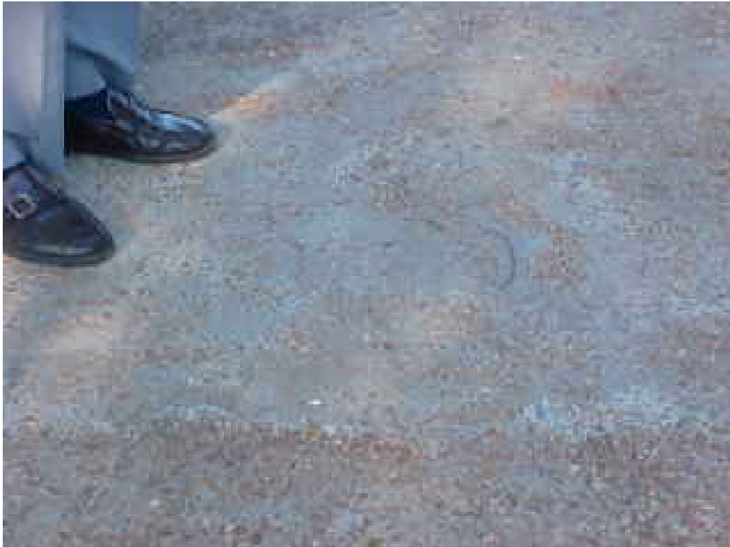
FOTO N° 18: Plaza Las Residentas. Mala terminación del piso de canto rodado in situ de los camineros.
