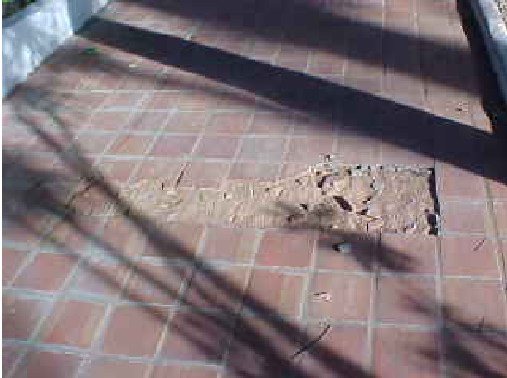
FOTO N° 3: Plaza Juan de Ayolas. Caminero deteriorado
