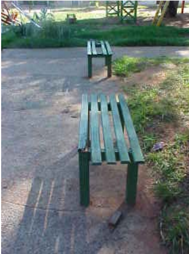
FOTO N° 13: Plaza Las Residentas. Bancos nuevos colocados, a pesar del poco tiempo de uso, se hallan prácticamente destruidos.
