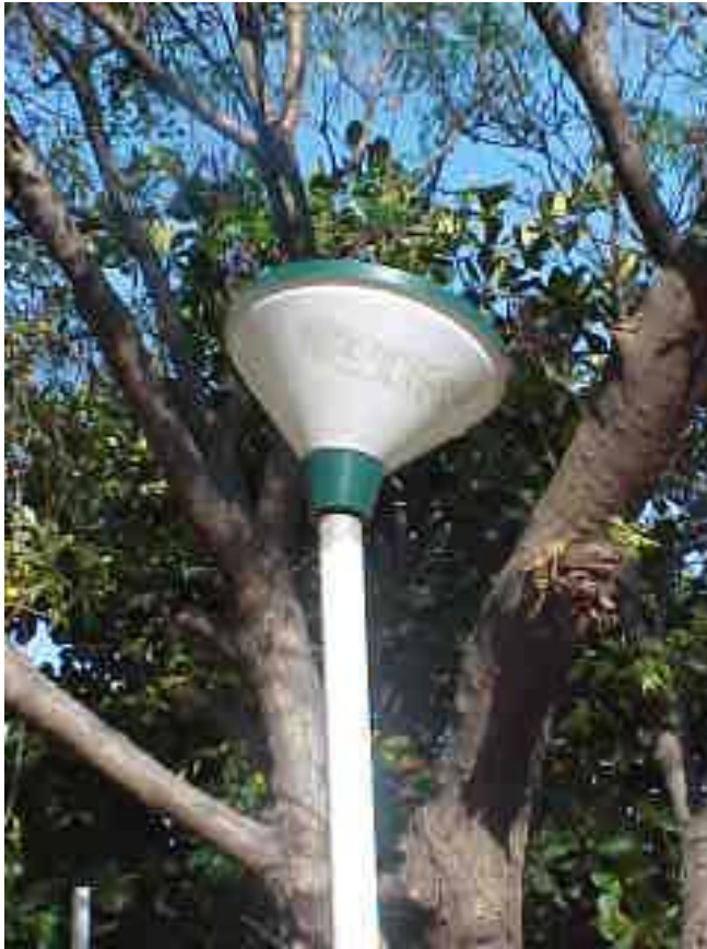
FOTO N° 9: Plaza Alicia Lynch. Artefacto de iluminación nuevo instalado.
