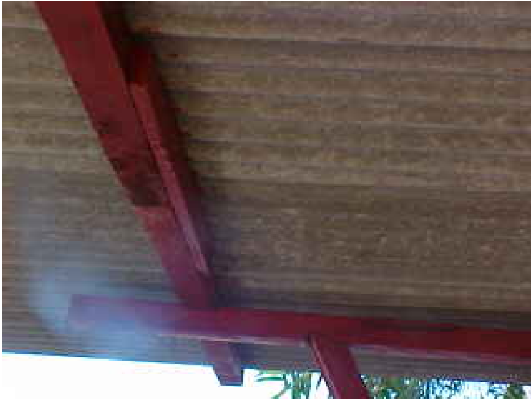
FOTO N° 22: Plaza Las Residentas. Detalle del techo en el resguardo para pasajeros que se observa en la foto anterior. Nótese la mala calidad de los trabajos (ver unión a tope).
