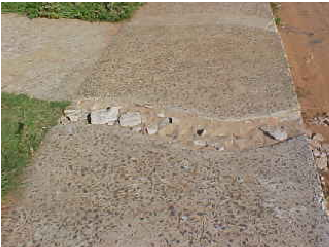
FOTO N° 17: Plaza Las Residentas. Desprendimiento del piso de cemento alisado en la vereda norte. Se observa la falta de contrapiso en este sector.
