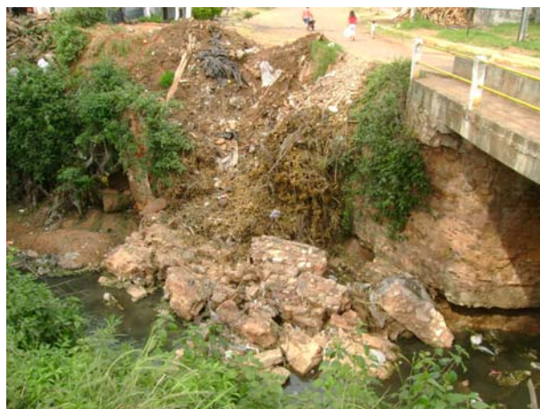
Escombros que obstaculizan el cauce natural bajo el puente.
