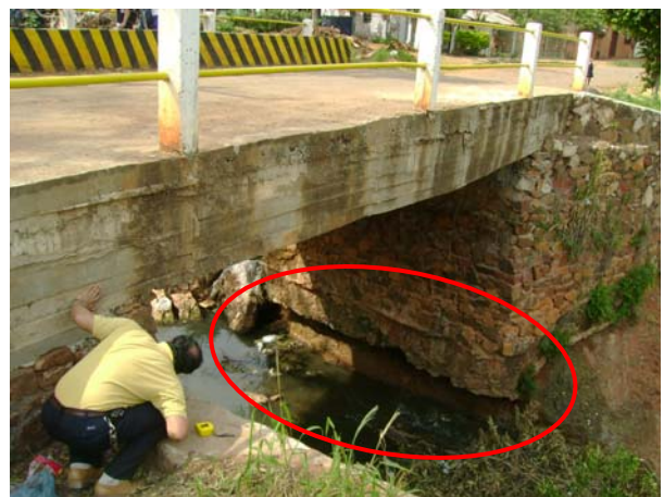
Socavación bajo los muros de piedra bruta existentes, que apeliagra su estabilidad.
