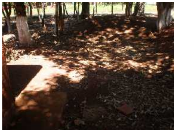
Camara septica y pozo absorbente sin registro de inspección conforme diseños aprobados por el MEC
