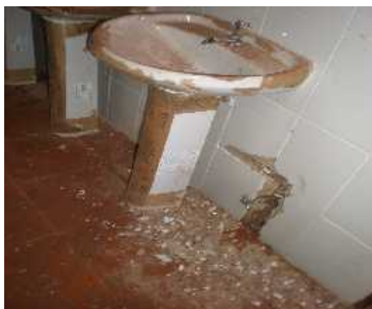
Artefactos sin agua por deficiencias en la conexión.
