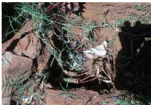
Registro electrico sin tapa, conductores y aislación precaria. En contravención al Reglamento para Instalación Electricas de Baja Tención (ANDE)
