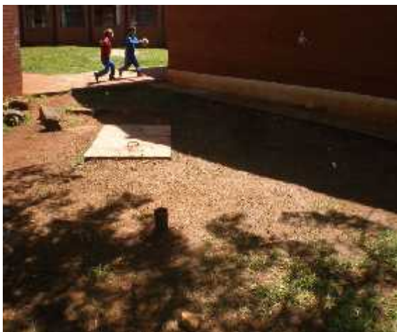
Pozo aborvente con ventilación no apropiada y sin registro de inspección.
