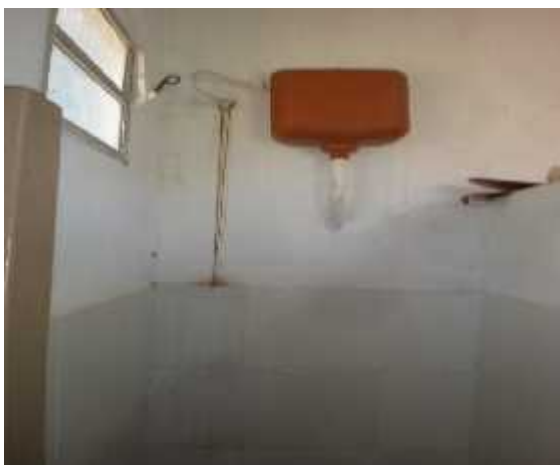
Instalación Sanitaria Deficiente.
