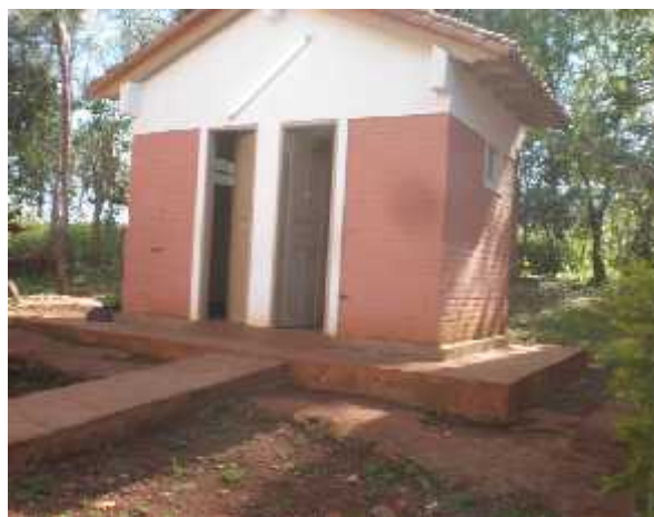
SS.HH. sin tablero electrico (sin protección)
