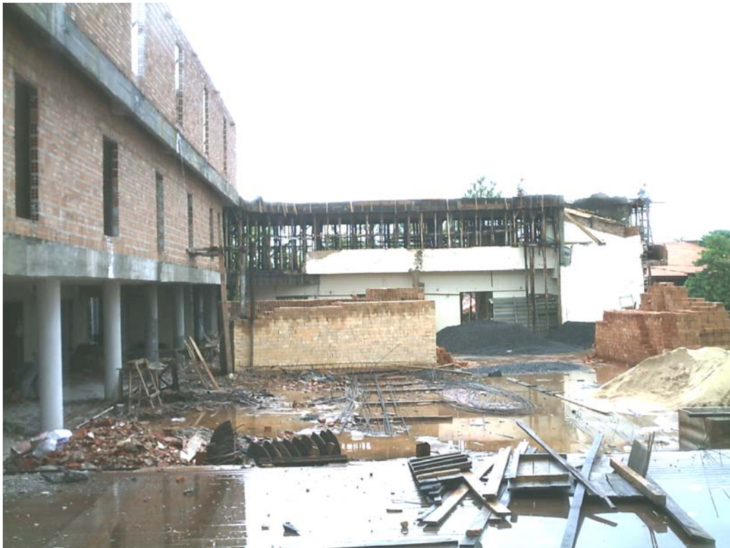
FOTO N° 2: fachada interna del futuro sector oficinas y del acceso al teatro, vista desde el escenario. Se observa la falta de limpieza de la obra.
