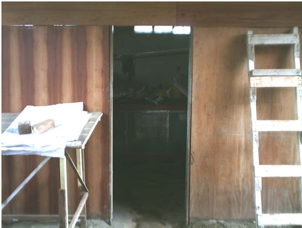
FOTO N° 5: vista del obrador, ubicado bajo la losa existente en el acceso al futuro teatro. No fue construido como establecen las EETT.
