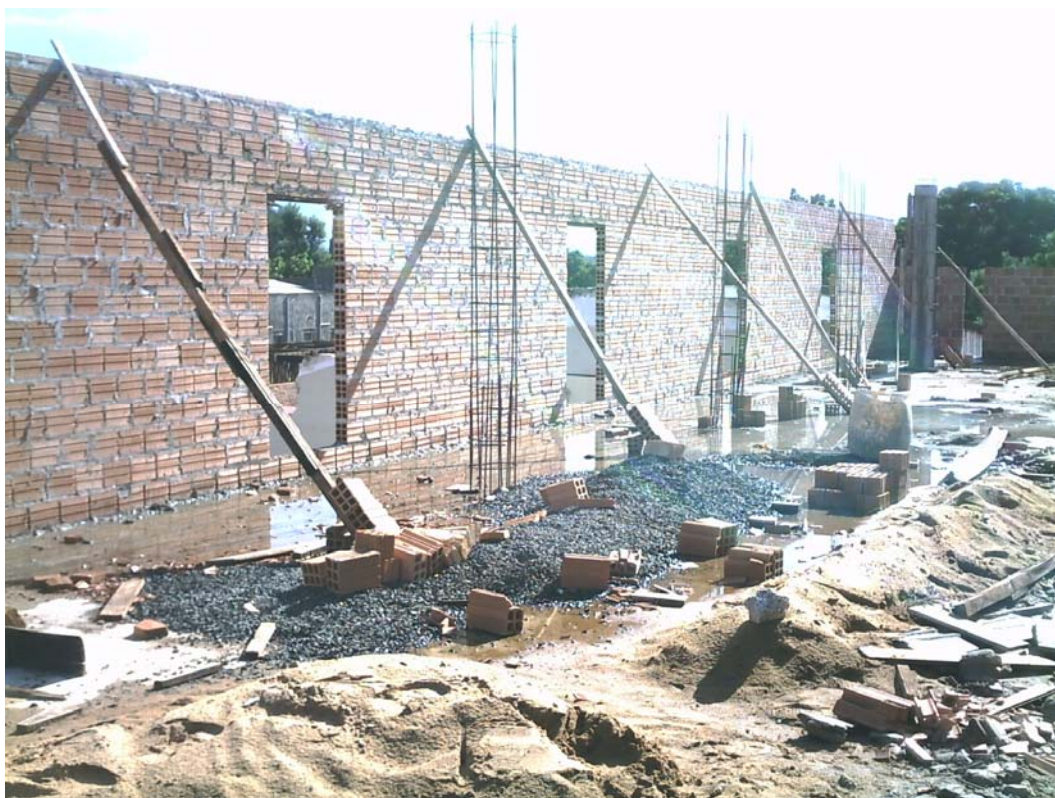
FOTO N° 8: apuntalamiento insuficiente de muro en el tercer nivel, quedando peligrosamente expuesto a la acción del viento.
