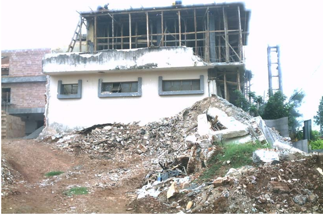
FOTO N° 1: vista de la fachada lateral desde la calle. Escombros provenientes de la demolición, que no fueron retirados por el Contratista.
