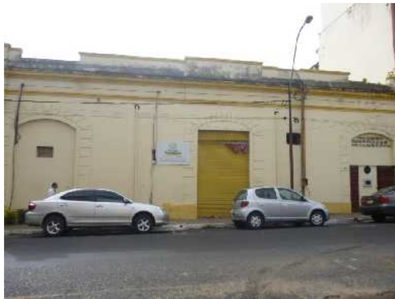
Falta de Vallado de Obra y Letrero de Obra.
