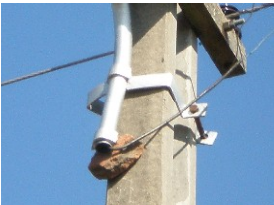
Sujeción del brazo de un artefacto de alumbrado, con una sola abrazadera de amarre, rudimentario calce con cascote y la utilización de bulones inadecuados ya oxidados, que deben ser galvanizados.
