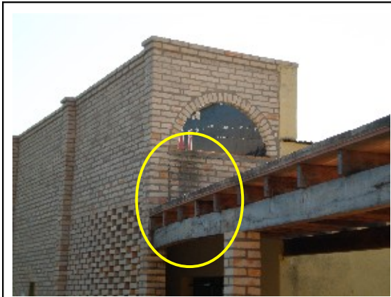
Problemas de humedad (bajo el arco de medio punto, según la mancha que se observa), por desagüe inadecuado del techo plano de la galería frontal. Además, se observa una viga de madera deformada.
