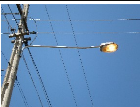
Brazo de artefacto fino y ya deformado, con un solo punto de sujeción a la columna y fotocélula descompuesta.
