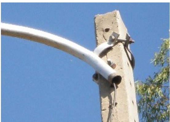
Toma con mayor acercamiento del mismo punto de sujeción que la foto de la izquierda, que permite observar la precaria sujeción del brazo de soporte del artefacto, mediante una abrazadera inadecuada para el tipo de sección del poste.
