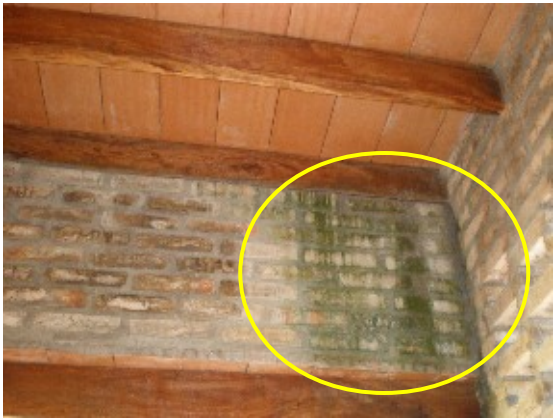
Vista del mismo sector con humedad, pero desde el interior de la galería frontal.
