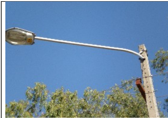
Artefacto sujetado precariamente con un solo punto de sujeción, que se encuentra peligrosamente inclinado y a punto de caer.
