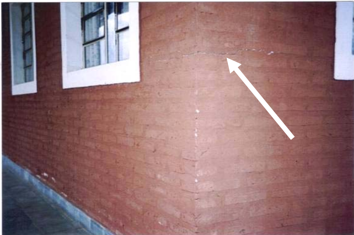
FOTO N° 106 - FOTO DESDE EL EXTERIOR DE LA ESTRUCTURA. SE OBSERVAN LAS GRANDES GRIETAS EN PAREDES DEL PUESTO DE SALUD, EVIDENCIANDO GRAVÍSIMOS PROBLEMAS ESTRUCTURALES.
