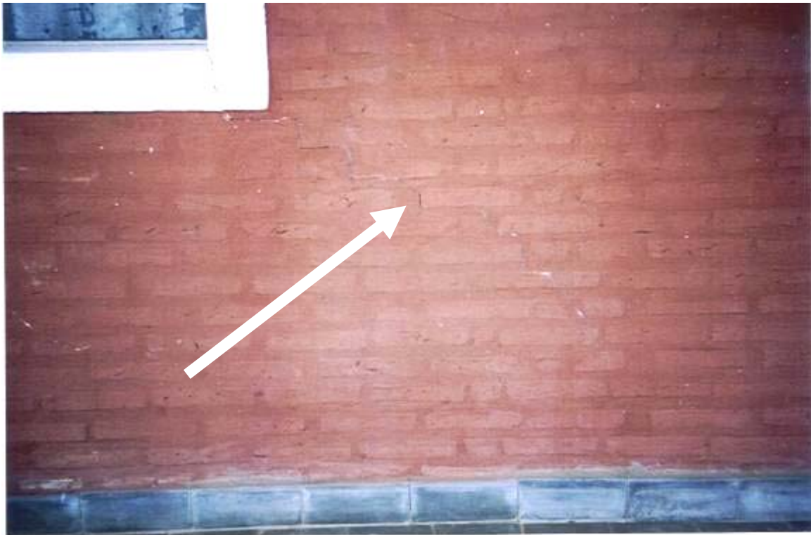
FOTO NÚMEROS 107 Y 108 - FOTOS DESDE EL EXTERIOR DE LA PAREDES DEL PUESTO DE SALUD, CON GRAVÍSIMAS GRIETAS QUE EVIDENCIAN HUNDIMIENTO Y DESPLAZAMIENTO DE LA MAMPOSTERÍA DE MATERIAL Y SU DESCONEXIÓN DE LA ESTRUCTURA DEL TINGLADO.(FLECHAS)
