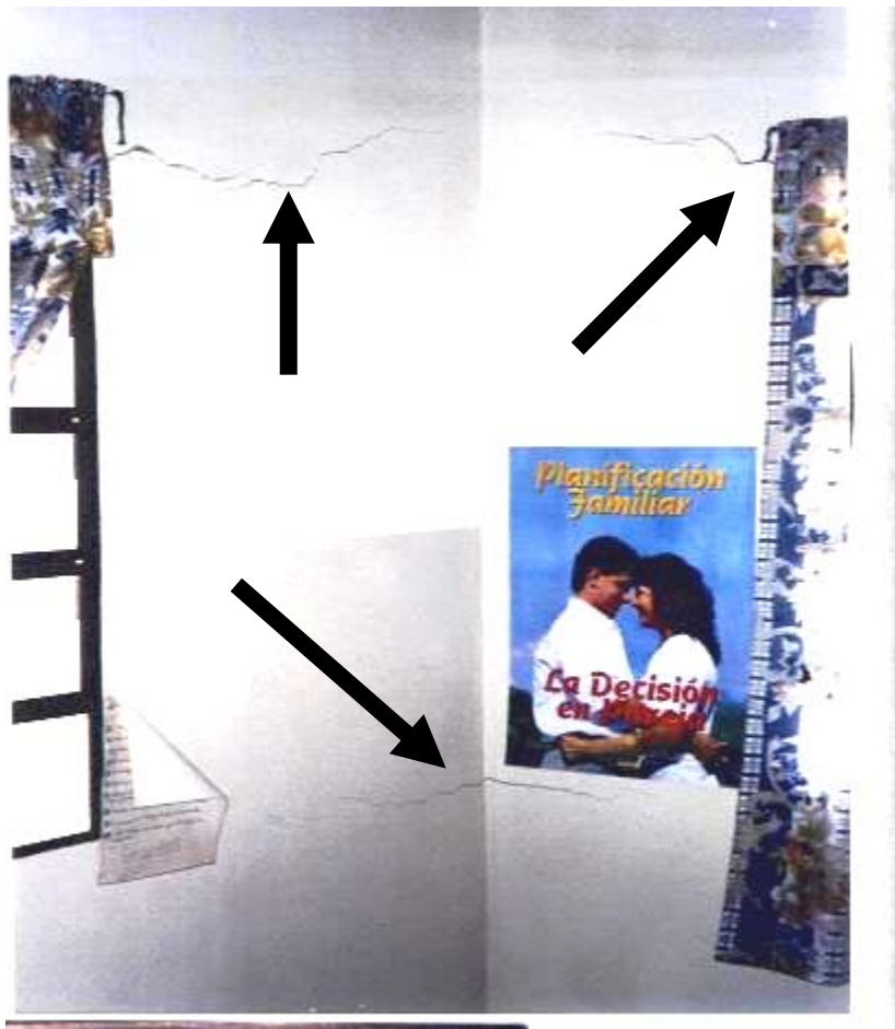
FOTO N° 110 - FOTO DESDE EL INTERIOR DEL PUESTO DE SALUD, LAS FLECHAS SEÑALAN LA GRANDES GRIETAS LAS GRIETAS SON GENERALIZADAS, PELIGRANDO EL COLAPSAMIENTO DE LA MAMPOSTERÍA CON EL TIEMPO, SI NO SE SOLUCIONA URGENTEMENTE. LA AUDITORÍA REALIZO RELEVAMIENTO DE LOS EQUIPOS, AMOBLAMIENTOS Y EFECTUÓ MEDICIONES
