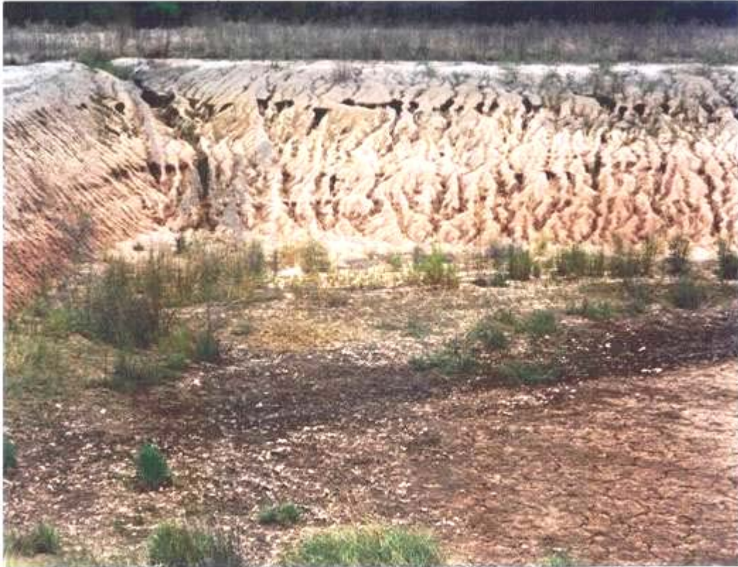
FOTO N° 98 – OTRA FOTO DEL TAJAMAR FINANCIADO POR PRODECHACO, NOTÁNDOSE LA PROFUNDIDAD DEL TAJAMAR Y LA GRAN EROSIÓN EN TALUD
