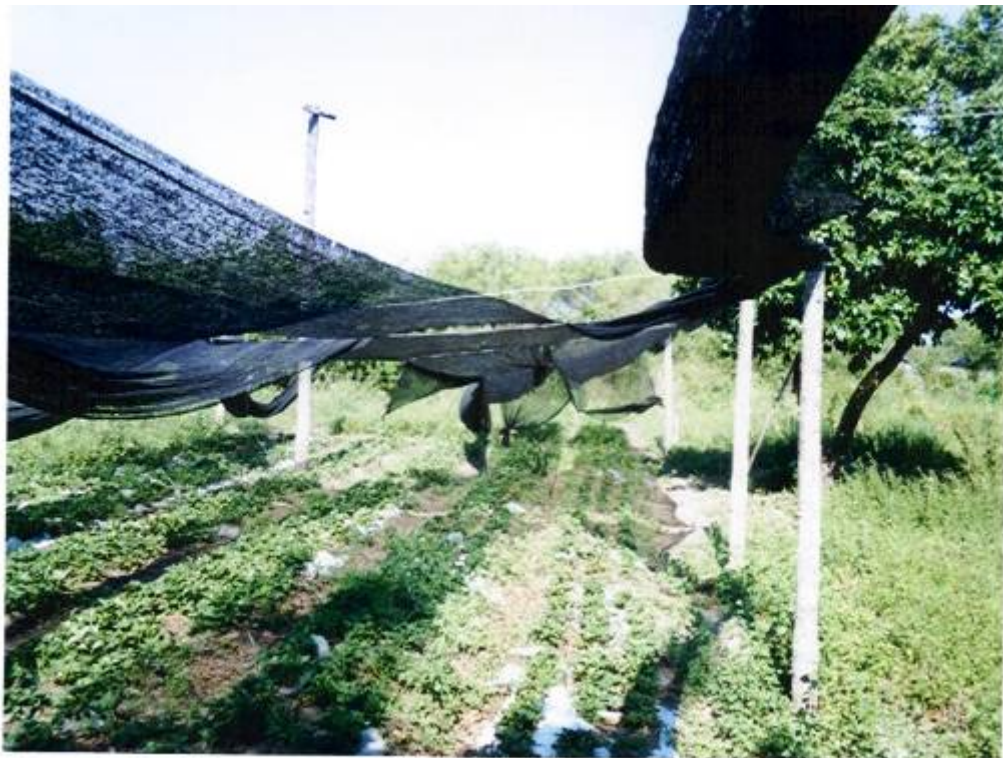
FOTO N° 69 – HUERTA COMUNITARIA CON SISTEMA DE RIEGO PROVEÍDO POR PRODECHACO PARA LA HUERTA. TAMBIÉN POSEE MALLA MEDIA SOMBRA QUE SE ENCUENTRAN SEMI DESTRUIDOS POR LA ACCIÓN DEL VIENTO. ESTE DEFECTO SURGE PRINCIPALMENTE POR LA DEFICIENCIA EN SU INSTALACIÓN, PUES NO SE PUSIERON TIRANTES ENTRE POSTES Y SOLO SE ENTRAMARON CON ALAMBRE. ESTOS ÚLTIMOS SE AFLOJAN AL CALENTARSE Y POR INCLINACIÓN DE LOS POSTES, OCACIONANDO LA PERDIDA DE FIJACIÓN DE LA MALLA Y FAVORECIENDO LA ACCIÓN DESTRUCTORA DEL VIENTO. LA HUERTA NO SE ESTA REGANDO POR FALTA DE AGUA EN LA FUENTE. LAS PLANTAS DE FRUTILLAS ESTÁN SEMI SECAS Y EN GRAN PARTE SIN SOMBRA DE PROTECCIÓN. SE NOTA UNA DEJADEZ POR FALTA DE REPARACIÓN DE LAS MALLAS TAN COSTOSAS. SE REALIZA MEDICIONES PARA CALCULO APROXIMADO DE MATERIALES PROVEÍDOS, MEDÍA SOMBRA, CAÑOS DE 1 ½ , CAÑOS DE ½ , GRIFOS, CODOS, ETC.
