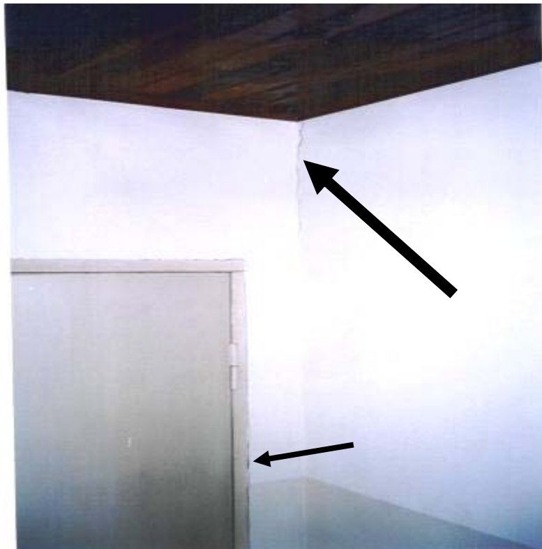
FOTO N° 111 - FOTO DESDE EL INTERIOR DEL PUESTO DE SALUD. LA FLECHA CHICA INDICA LOS DEFECTOS EN LA FIJACIÓN DE LOS MARCOS. LA FLECHA GRANDE MUESTRA GRIETAS EN LA PARTE SUPERIOR EN LA UNIÓN DE PAREDES
