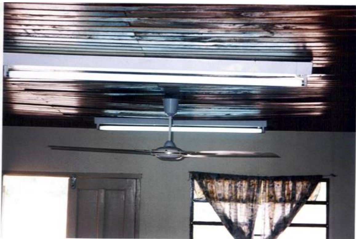
FOTO N° 112 - TECHO MACHIMBRE DE MADERA DEL PUESTO DE SALUD CON GRANDES DEFECTOS.
