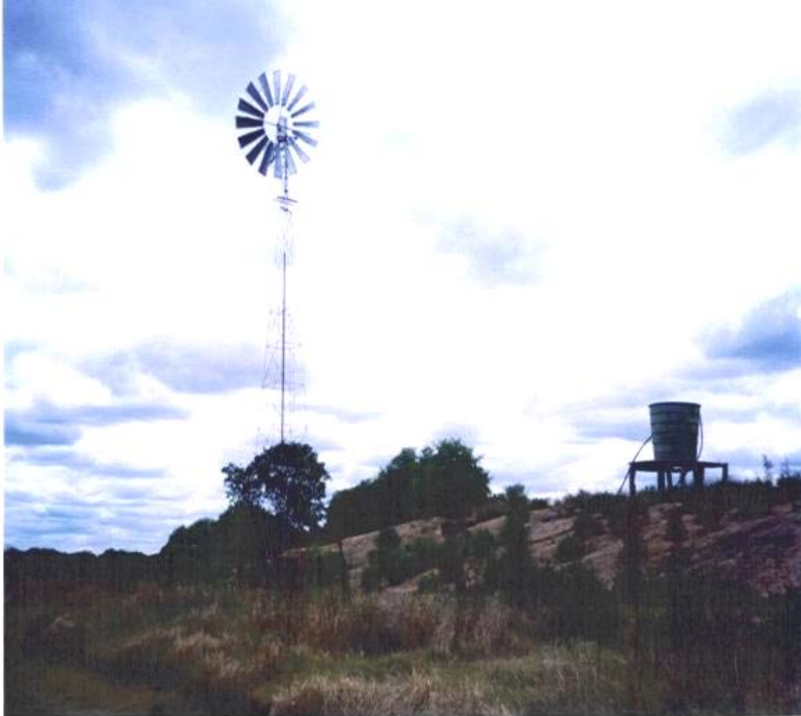
FOTO N° 124 - MOLINO DE VIENTO Y TANQUE PROVEÍDO POR PRODECHACO, CONECTADO A CAÑERÍA QUE VA HASTA LA COMUNIDAD, CON UN EMPLAZAMIENTO APROX. DE 700 MTS. AL MOMENTO DE LA VISITA LA VÁLVULA Y FILTRO DE SUCCIÓN ESTÁN CON DESPERFECTOS, POR LO QUE EL SISTEMA NO SE HALLA FUNCIONANDO..
