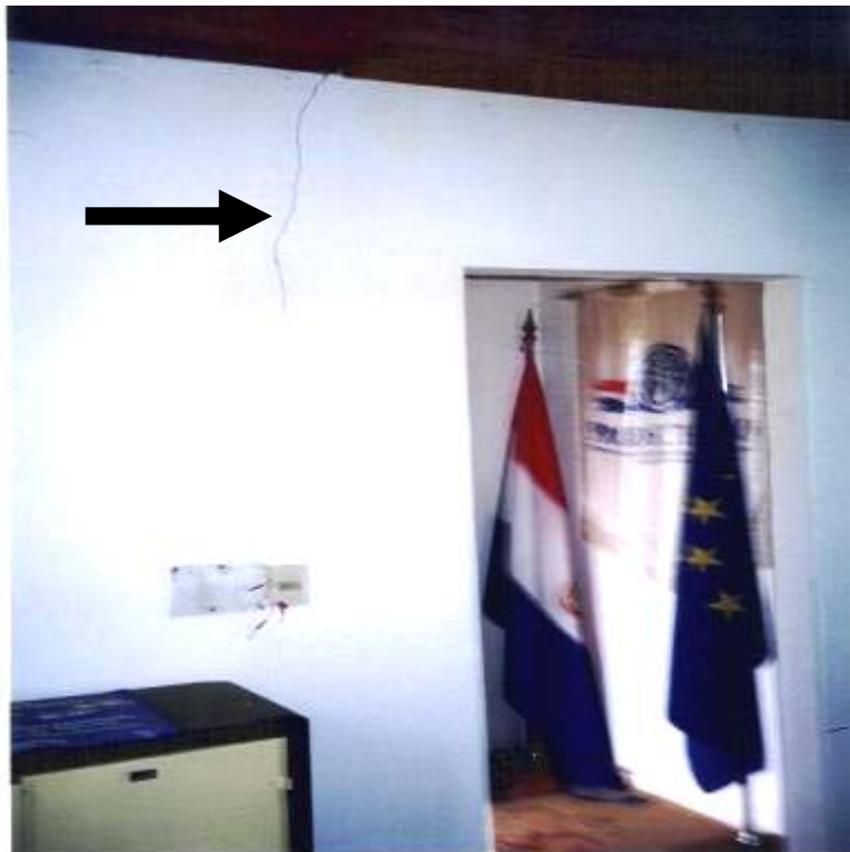
FOTO N° 89 - VISTA INTERIOR DE LA OFICINA (COORDINACIÓN DEPARTAMENTAL DE BOQUERÓN). LA FLECHA SEÑALA GRIETAS EN LA PARED HAY RASTROS DE CABLES ELÉCTRICOS DE DESCONEXIONES DE VENTILADORES Y EQUIPOS ELÉCTRICOS
