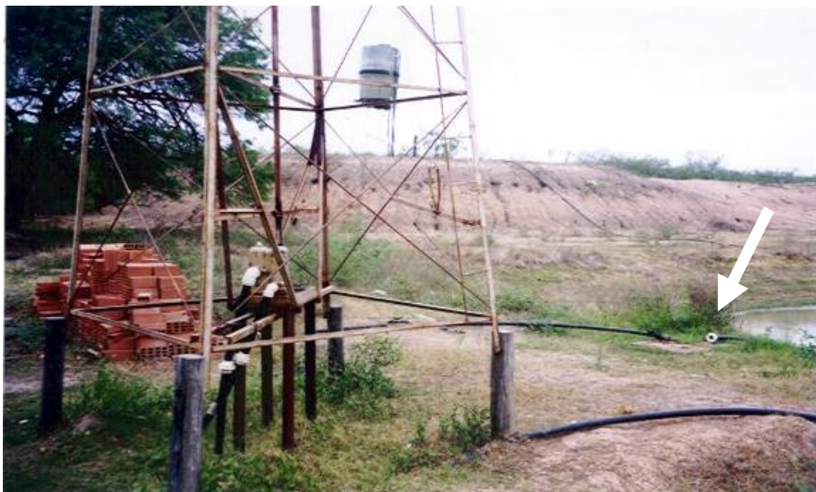
FOTO N° 117 - MOLINO DE VIENTO DEFICIENTE EN SU CAPACIDAD DE BOMBEO PARA VENCER LA ALTURA DEL TANQUE, OCASIONO QUE LA COMUNIDAD ADQUIERA UNA MOTOBOMBA PARA BOMBLEAR DOS VECES AL DÍA AGUA AL TANQUE (INCLINADO) SE NOTA LOS CAÑOS PARA CONEXIÓN DE LA MOTOBOMBA (FLECHA) EL SISTEMA DE DISTRIBUCIÓN POR CAÑERÍAS PRODECHACO LLEGA A LAS CASAS DE LA COMUNIDAD CON UN EMPLAZAMIENTO DE MAX. APROX. 3.500 MTS. SE REALIZÓ MEDICIÓN DEL TAJAMAR Y CÁLCULO DE CAPACIDAD DA A LA AUDITORÍA 13.440 M3, ARROJANDO UNA DIFERENCIA DE 1.730 M3 CON EL CÁLCULO DEL FISCAL DE OBRA QUE RECEPCIONÓ EL TAJAMAR.. EN EL TAJAMAR SE CONSTRUYÓ UN FILTRO CON GRAVAS QUE NUNCA FUNCIONÓ.
