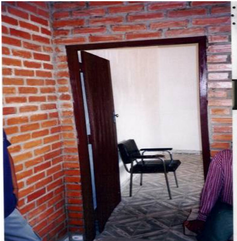
FOTO NÚMERO 95 - VISTA DEL INTERIOR DEL PUESTO. PISOS, PUERTAS DE TABLAS (SE NOTA DEFECTO ENCORVAMIENTO EVIDENTE EN LA ZONA DE SU FIJACIÓN AL MARCO.) Y SILLAS PROVEÍDAS POR PRODECHACO.
