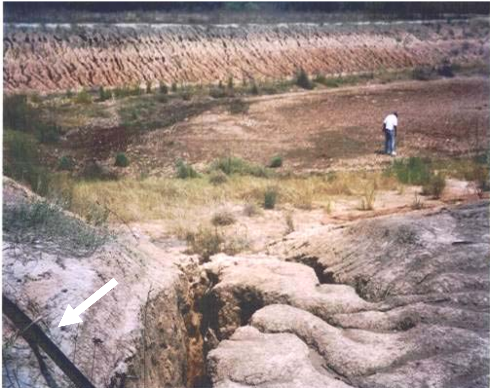
FOTO N° 97 - TAJAMAR CONSTRUIDO POR PRODECHACO CON EVIDENCIAS DE DEFECTOS EN SU TALUD Y EXCESIVA PROFUNDIDAD LLEGANDO A CAPAS DE SUELOS FILTRANTES. LA GRAN EROSIÓN DE LOS TALUDES DESDE LA SUPERFICIE HASTA EL FONDO EVIDENCIAN QUE HUBIERON GRANDES LLUVIAS, PERO SEGÚN MANIFESTACIONES DE LOS MIEMBROS DE LA COMUNIDAD EL TAJAMAR NO RETUVO AGUA. LA FLECHA INDICA EL EMPLAZAMIENTO DEL CAÑO PVC QUE VA HACIA EL TANQUE DE LA HUERTA.
