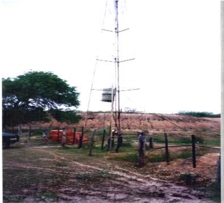
FOTO N° 116 - TAJAMAR, MOLINO DE VIENTO, TANQUE CON ESTRUCTURA, CAÑERÍAS ETC. PROVEÍDAS POR PRODECHACO. EN LA PARTE POSTERIOR SE NOTA EL TANQUE CON PLATAFORMA METÁLICA INSTALADO SOBRE TIERRA SOBREELEVADA. SE VISUALIZA GRAVE INCLINACIÓN DE LA BASE.
