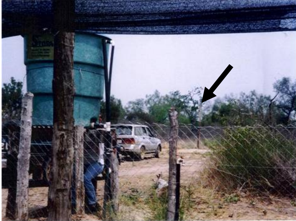
FOTO N° 96 – TANQUE DE AGUA Y SISTEMA DE RIEGO DE HUERTA COMUNITARIA. DEFICIENCIA EN EL CALCULO DE NIVEL TOPOGRÁFICO EN LA IMPLANTACIÓN DEL TANQUE DE 5.000 LTS. INSTALADO POR PRODECHACO, CUYO ABASTECIMIENTO DE AGUA PROVIENE DE UN POZO ARTESIANO CONSTRUIDO POR UNICEF QUE SE ENCUENTRA DISTANTE A 800 MTS. DE LA HUERTA PRIMERO SE INSTALÓ A UNOS 30 MT. DE LA HUERTA Y A UNA ALTURA APROXIMADA DE 5 MTS. (LA FLECHA AL FONDO DE LA FOTO SEÑALA LA BASE INICIAL), Y AL NO SUBIR EL AGUA AL TANQUE MUDARON A 1,15 MT. DE ALTURA. (DOBLE GASTO DE IMPLANTACIÓN) EN ESTE LUGAR SE EQUIPO UNA HUERTA COMUNITARIA CON SISTEMA DE RIEGO CON CAÑOS PVC DE 1 ½ Y PARA GOTEO DE ½", MALLA MEDIA SOMBRA, ALAMBRE TEJIDO, GRIFOS, SEMILLAS, HERRAMIENTAS, ETC. NO RECIBE AGUA DEL TAJAMAR CONSTRUIDO A UNOS 1.000 MT. DEL LUGAR POR PRODECHACO PORQUE NO SE PROVEYÓ DE LA MOTOBOMBA Y ACTUALMENTE ESTA TOTALMENTE SECO.
