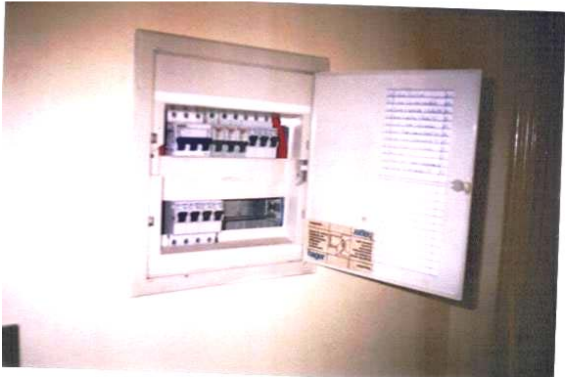
FOTO N° 86 - TABLERO DE LLAVES TERMO MAGNÉTICAS CON CAPACIDAD PARA CONECTAR EQUIPOS MÉDICOS
