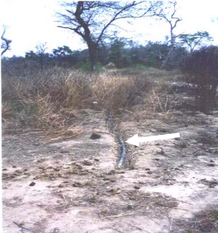
FOTO N° 102 - SISTEMA DE DISTRIBUCIÓN DE AGUA POR CAÑERÍAS Y CONSTRUCCIÓN DE DOS ALJIBES EN LA COMUNIDAD. EL CAÑO QUE SE OBSERVA EN LA FOTO PROVIENE DESDE UN TAJAMAR DISTANTE A 1.700 MT. DEL ALJIBE MÁS LEJANO. SE OBSERVA QUE LOS CAÑOS NO ESTÁN TOTALMENTE ENTERRADOS
