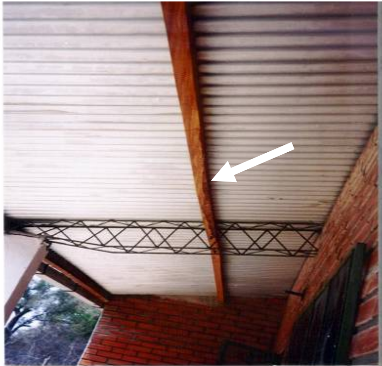
FOTO NÚMERO 94: TECHO TINGLADO DEL LOCAL DE SALUD, SECTOR ACCESO FRONTAL. SE NOTA DEFECTOS EN EL TIRANTE DE MADERA (FLECHA)
