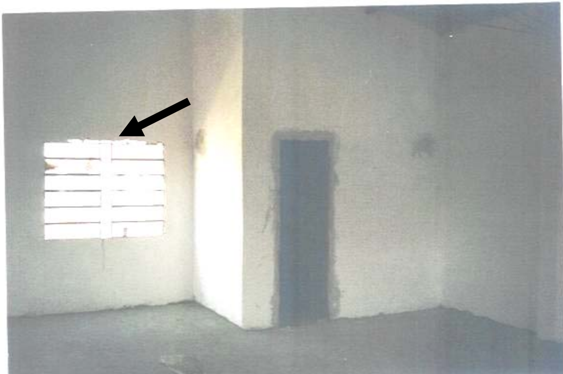
FOTO N° 74 - TOMA INTERIOR DE LA ESTRUCTURA. DEL ALMACÉN DE CONSUMO DE LA COOPERATIVA. SE VISUALIZAN DEFECTOS DE FIJACIÓN DE LAS ABERTURAS. LA FLECHA SEÑALA UNO DE LOS GRANDES DEFECTOS.
