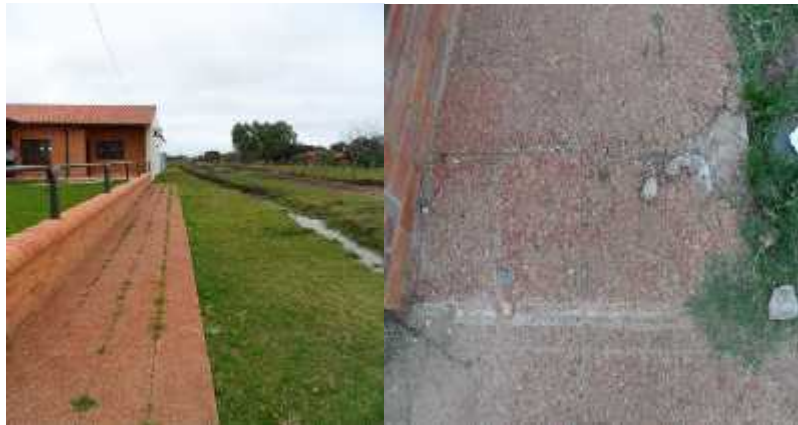
Césped en las juntas del piso.
