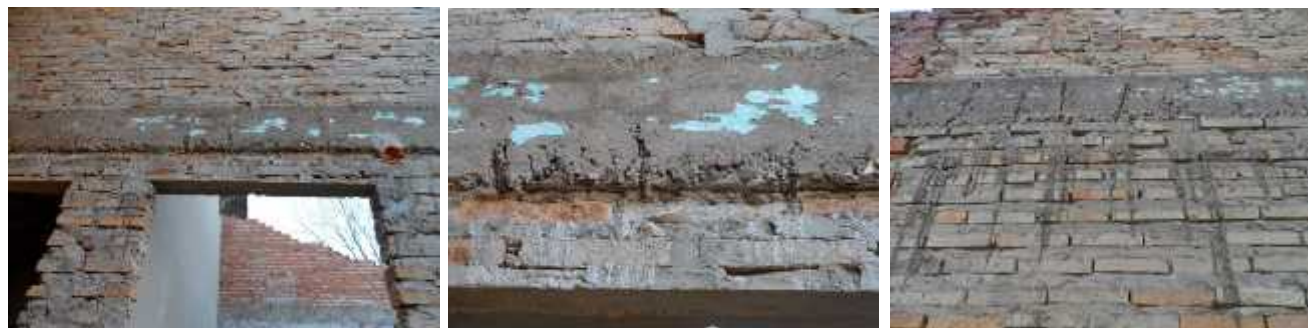
Coqueras y armaduras expuestas.
