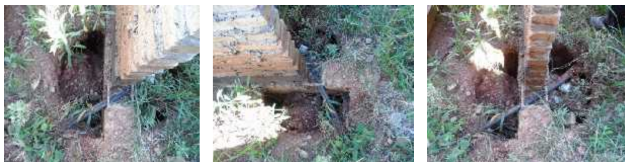
Viga de fundación con armaduras expuestas.
