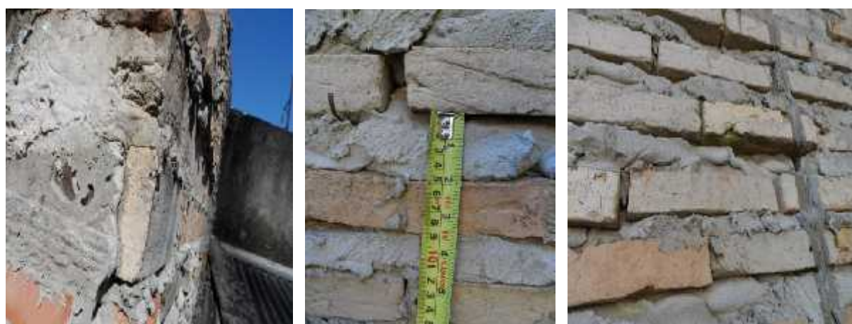
Juntas de mampostería con superficie irregular.
