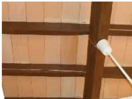
Empalme de tirantes sin refuerzo en apoyo.
