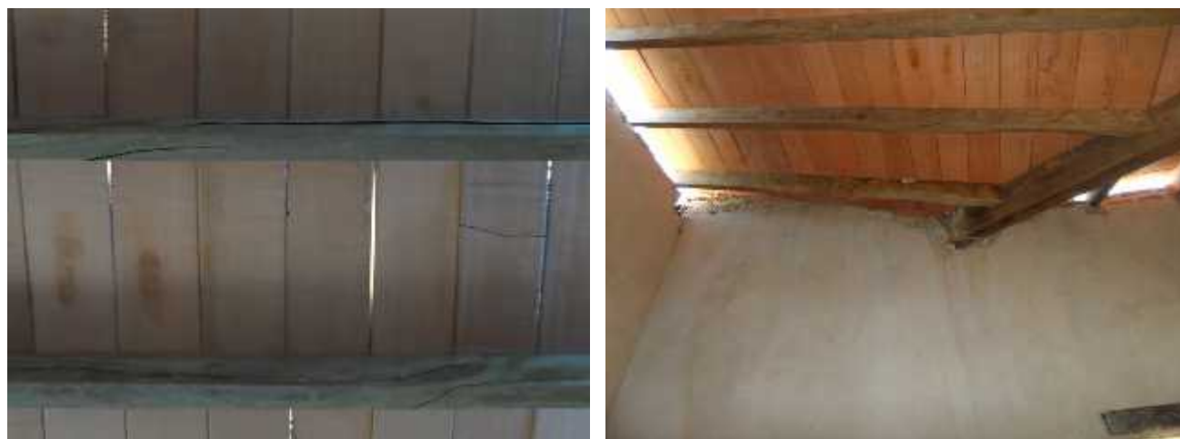
Tirantes con fisura y sección (escuadría) irregular.
