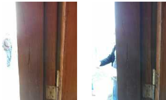
Marcos con grietas.
