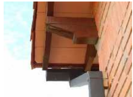
Maderamen con grietas y deformaciones.
