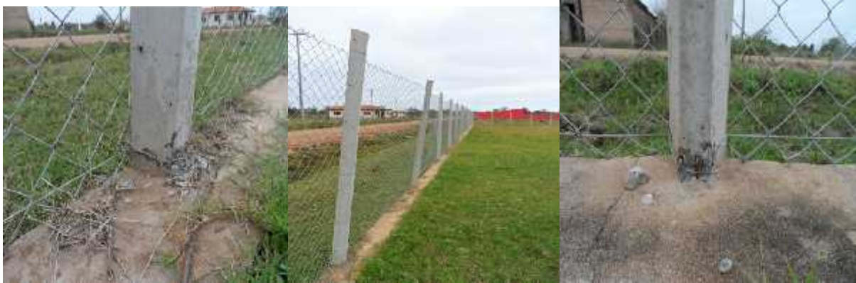
Postes de H° quebrados.
