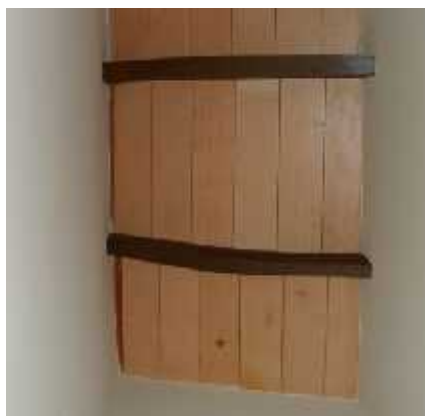
Tirantes con flexión lateral excesiva
