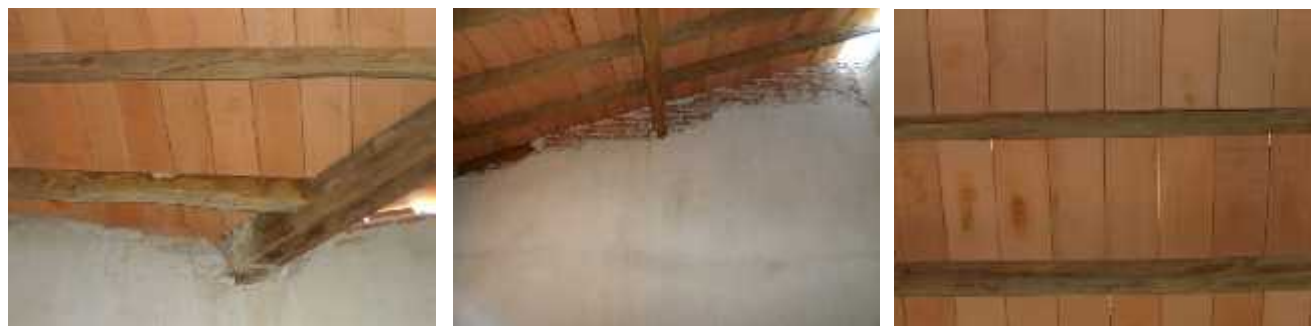
Techo de tejas con materiales de mala calidad y deficiente colocación.
