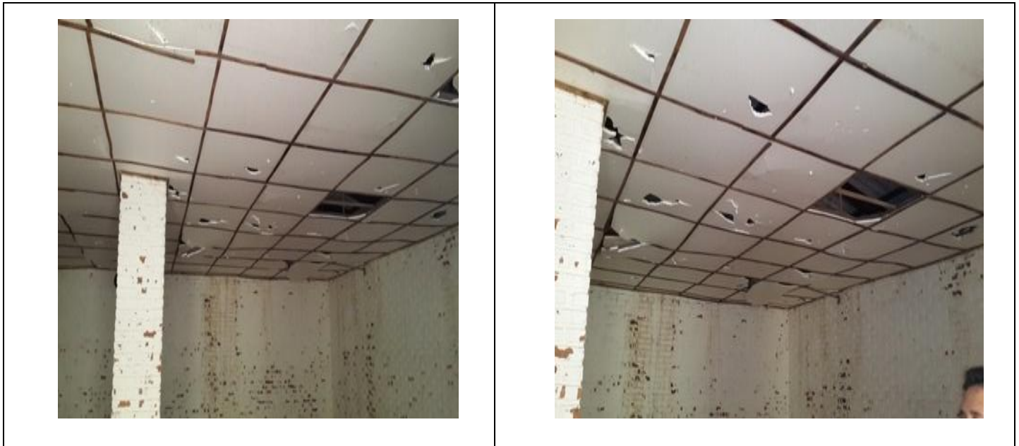
Foto N° 3 y 4: Se visualizan Polvorines en mal estado de mantenimiento DESCARGO
