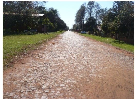
Empedrado sobre calle Cacique Canindeyú sin cartel de obras.
