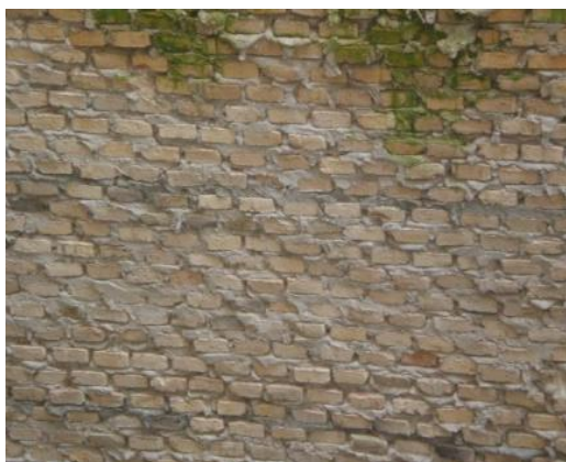
Foto 1: Las hiladas no se encontraban perfectamente horizontales
