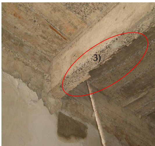
Foto 3: desprendimiento tramo a de la viga V6.
