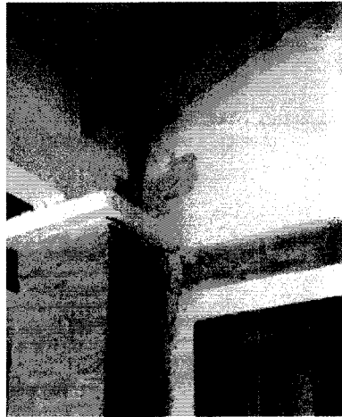
Mala terminación, entre el pilar y la pared
