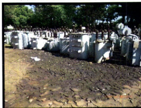
Encarnación – Itapúa Equipos averiados ubicados a la intemperie
