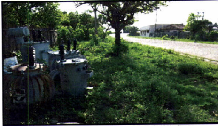
Transformadores almacenados en viviendas particulares. Fuente: Contraloría General de la República.
