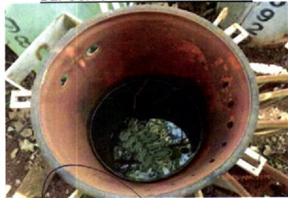
Transformadores con agua (potenciales criaderos de mosquitos).
