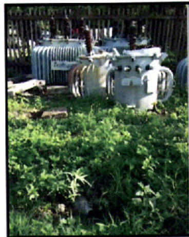
Transformadores averiados situados a metros de un canal de agua que desagua en el Río Paraguay
