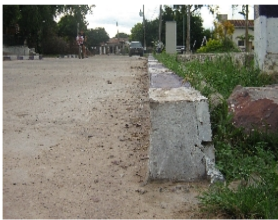
Cordón de HºAº ejecutado con canto vivo sin redondear o biselar, debido a la falta de especificaciones técnicas.
