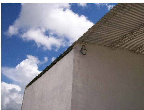
Falta de canaletas hacia el lado este. Nótese la rendija que queda entre la mampostería y el techo de chapas, haciendo que el agua de lluvia ingrese hacia el interior de la construcción.
