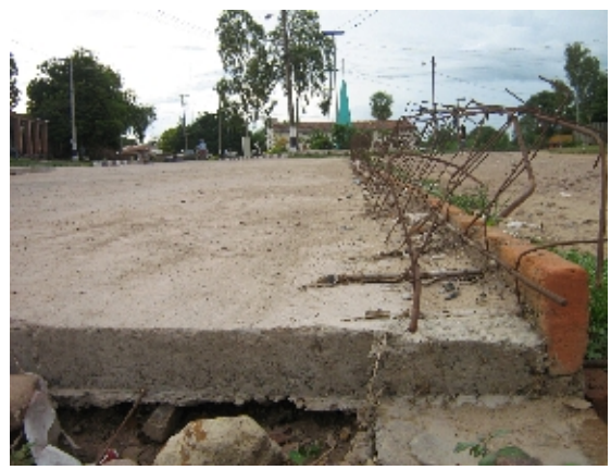
Construcción de cordón suspendida por orden verbal del intendente, por estar preparado para tener canto vivo. Abrupta terminación del borde del pavimento.
